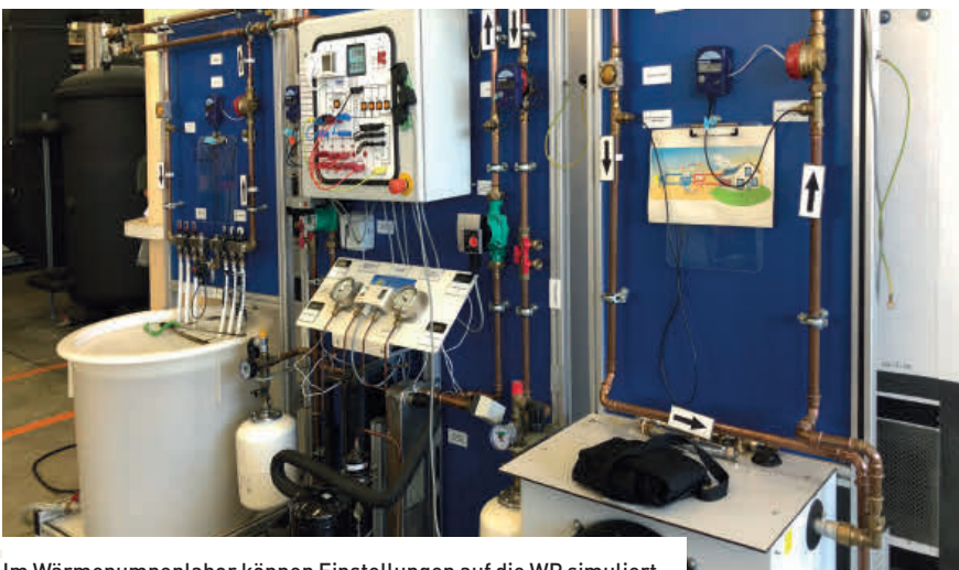
Im Wärmepumpenlabor können Einstellungen auf die WP simuliert werden und die Auswirkungen sind sofort ersichtlich.
